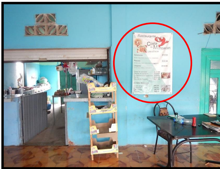
Área con daños al interior del Restaurante del lado Oeste. (Delimitada en un círculo)
