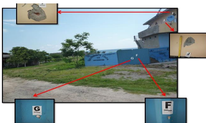
Daños en el portón y muro sur del segundo nivel.
