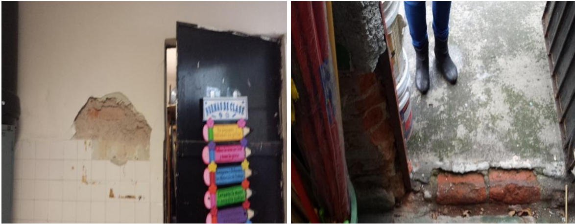
b) Presencia de humedad en paredes y techos.
