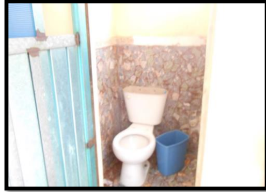
Figura 10. Sanitarios del CSH4.
