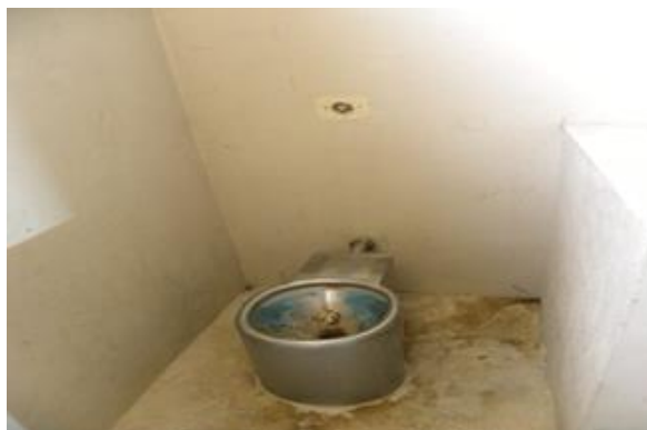
Servicio sanitario del Juzgado Calificador del municipio de San José Iturbide.
